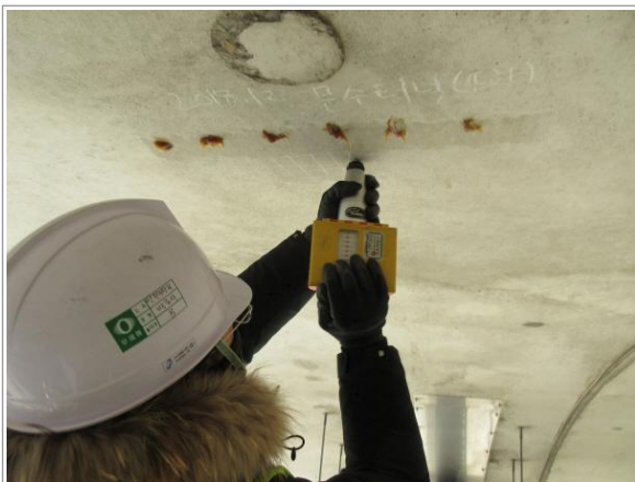
반발경도 시험 전경 ①
